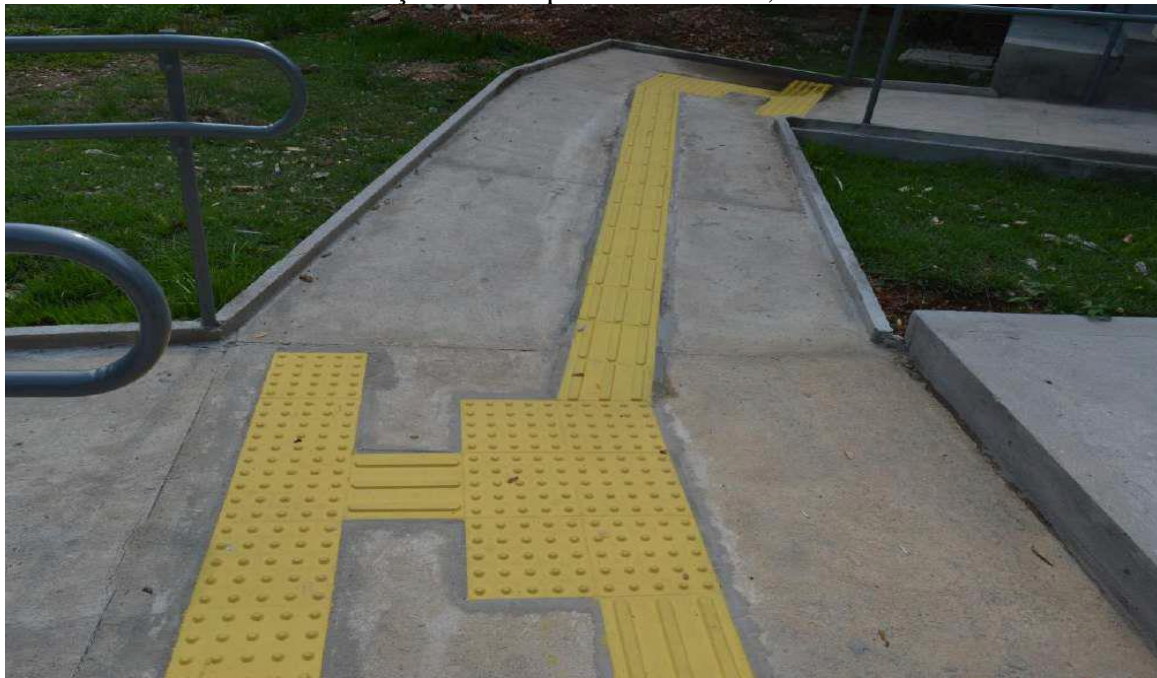
Foto 7 – Acessibilidade de calçadas e rampas na unidade II, Marabá-2019.
