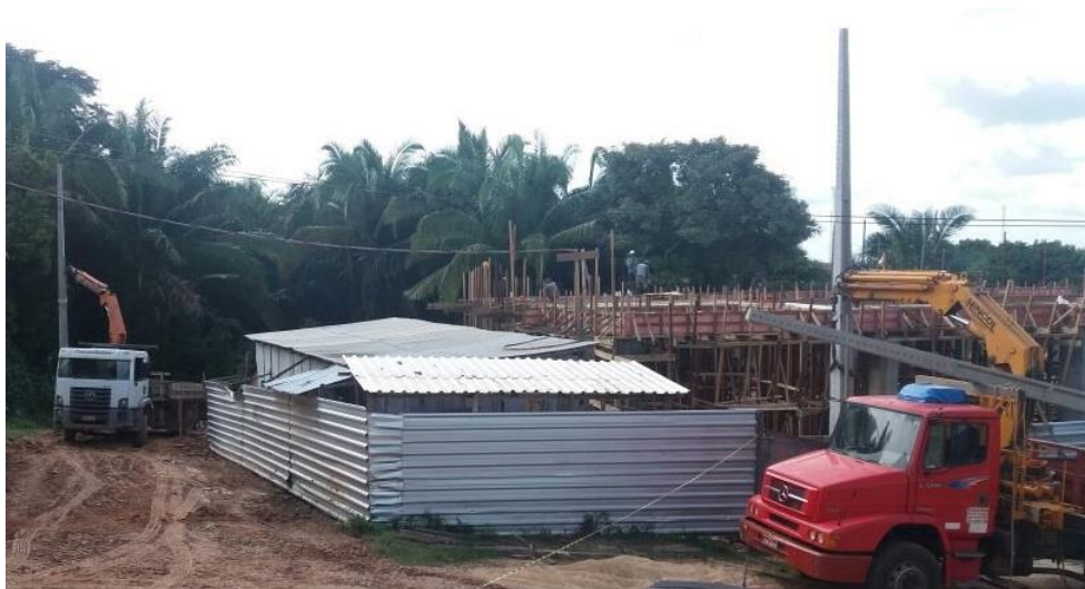
Foto 15 - Infraestrutura elétrica dos galpões da Unidade II, Marabá-2017
